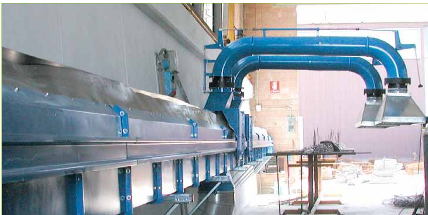
Blindocanalina con 2 cappe scorrevoli
