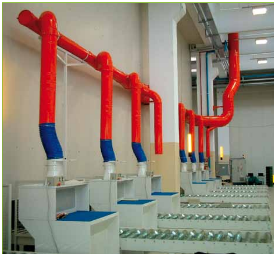
Impianto centralizzato con 6 banchi
