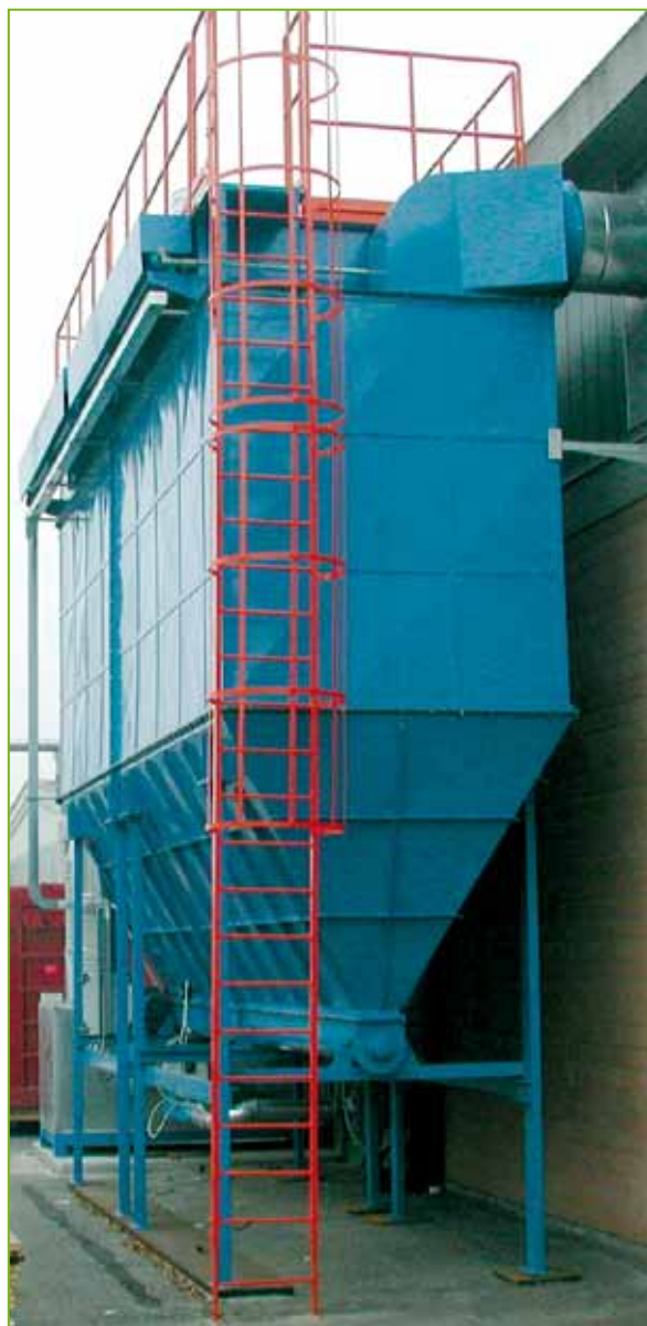
Sottostazione con pulizia ad aria compressa
