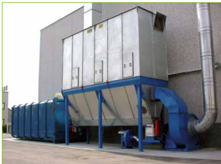
Sottostazione con pulizia a scuotimento
