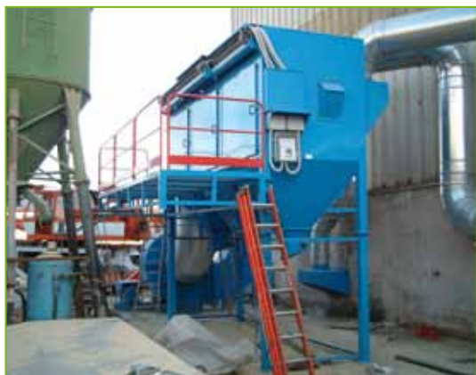
Applicazione su un impianto di sabbiatura
