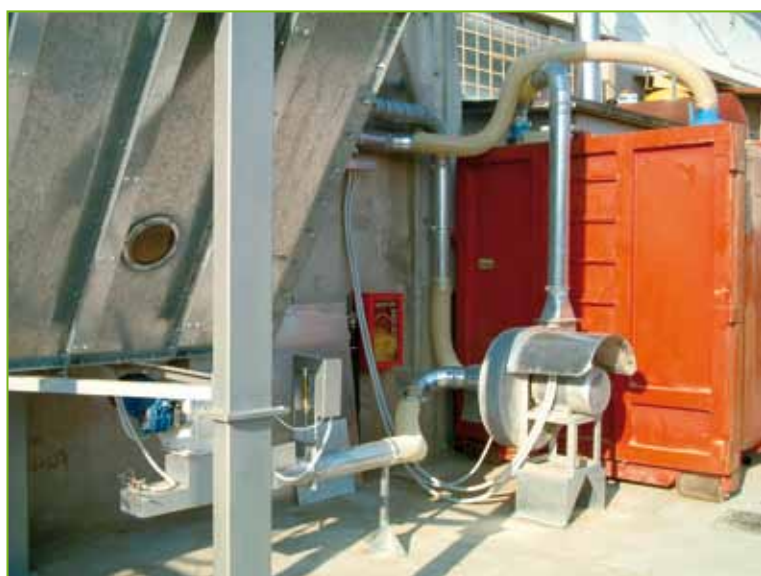
Sistema di trasporto pneumatico in container
