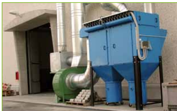
FINPOL GRX 48. Abbattimento polveri su di un impianto di trattamento rifiuti tossico-nocivi.
