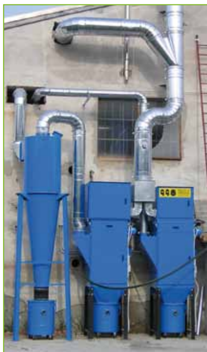
Aspirazione e filtrazione polveri metalliche da lucidatura. Preabbattimento con ciclone.
