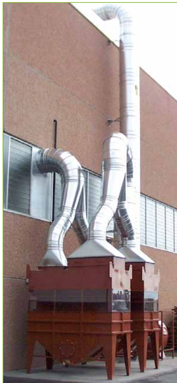
Impianto di abbattimento polveri esplosive
