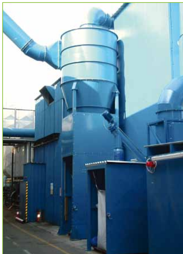
Pre-abbattimento in un impianto di aspirazione e filtrazione cellulosa e carbone attivo
