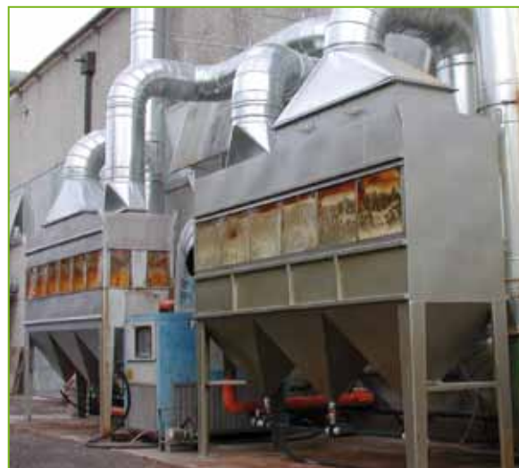
Impianto di abbattimento polveri di farina
