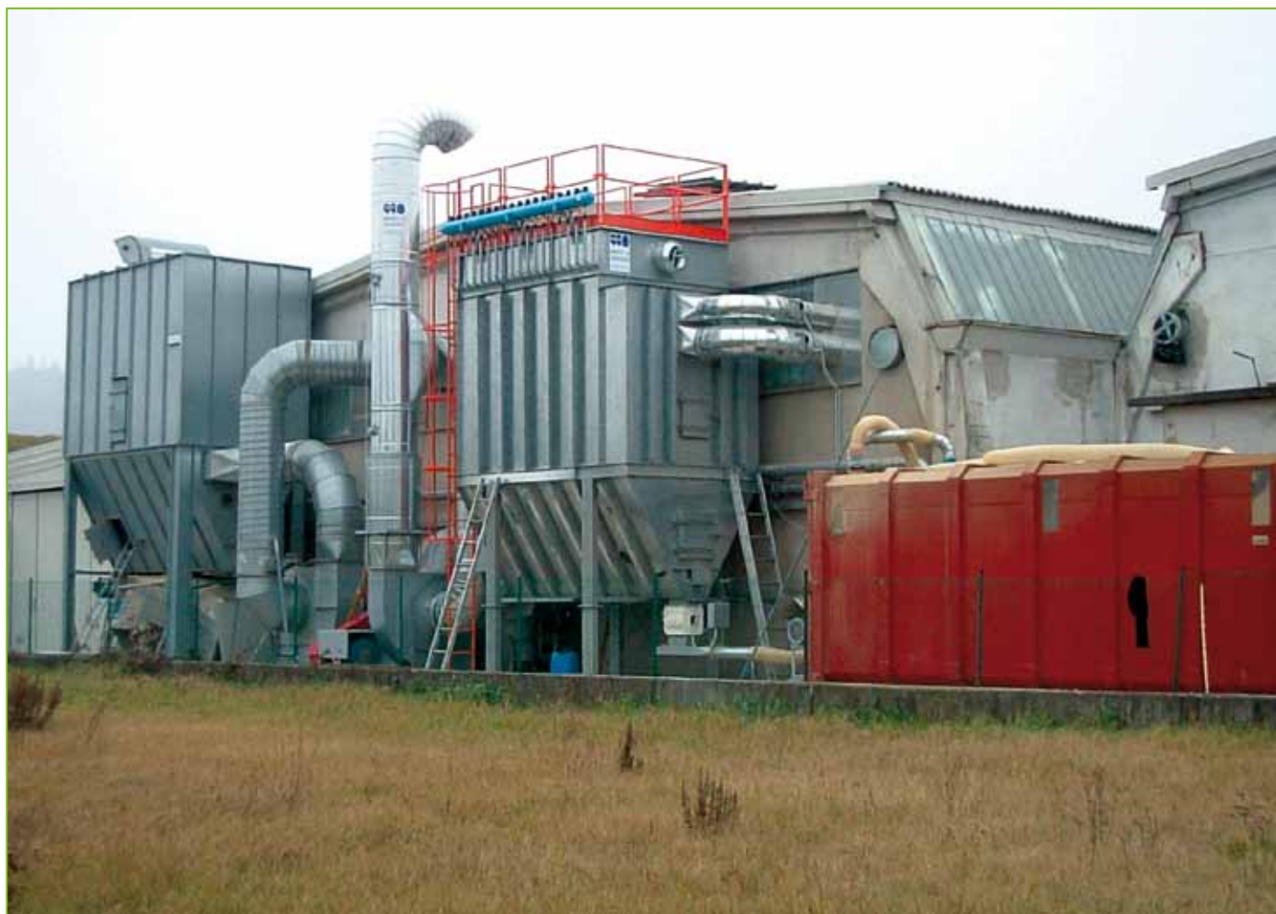
Impianto di abbattimento con doppia sottostazione
